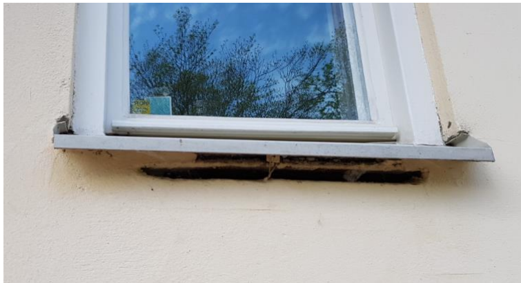
Figur 6. Tilluftsväntil i fasad.
