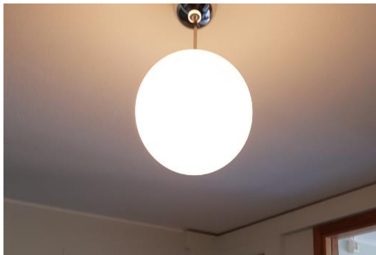
Figur 11. LED-belysning i trapphus.
